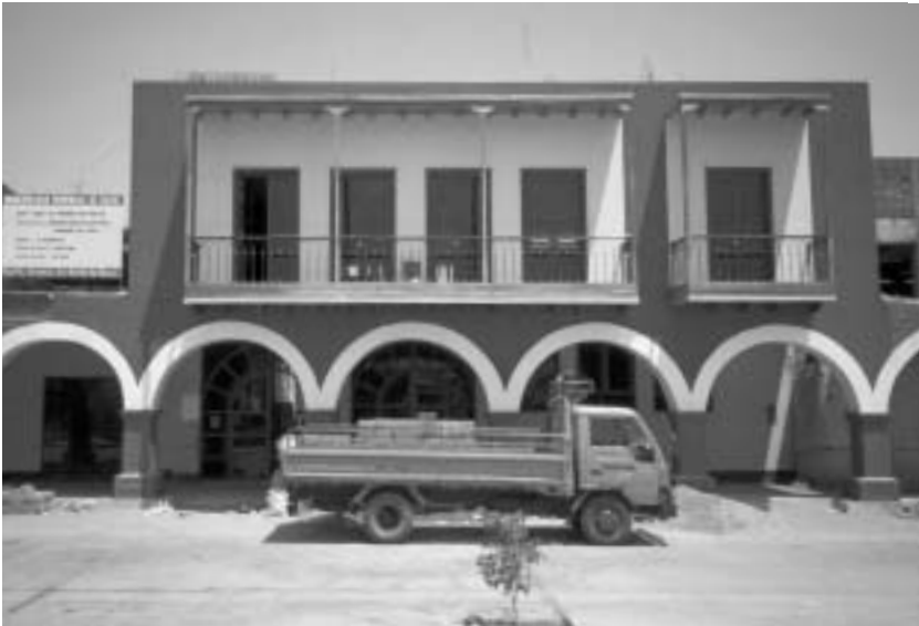
Abb. 20 Bauarbeiten im Obergeschoss des Rathauses von Palpa, wo das archäologische Lokalmuseum eingerichtet werden soll.
